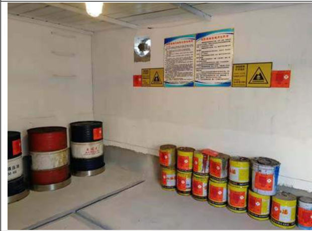
危废暂存间地面、围堰已做防渗处理，已张贴标志、标签、危废管理制度，已建立危废管理台账，危险废物分类暂存
