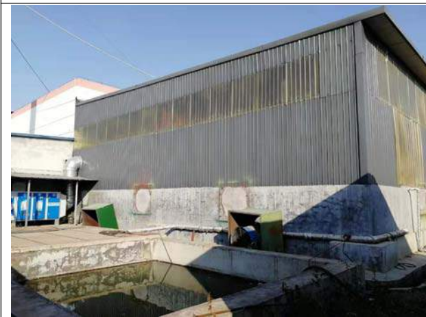
喷漆房全封闭，设置水帘+过滤棉+光氧化催化+活性炭吸附处理设施处理喷漆废气
